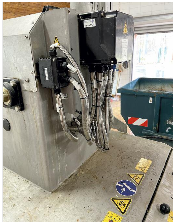
Zur Vermeidung von Rattenfraß in Metallschläuche gehüllte Kabel an der Rechenanlage
