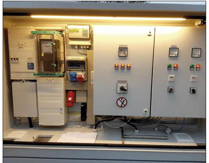
Das typische Innere eines Pumpwerksschaltzschanks (SWP Zur Erholung in Kesselsdorf)
