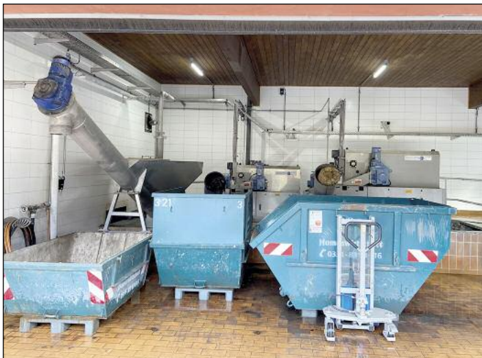
Rechenanlage im Abwasserpumpwerk Saubachtalweg (ehem. Kläranlage)
